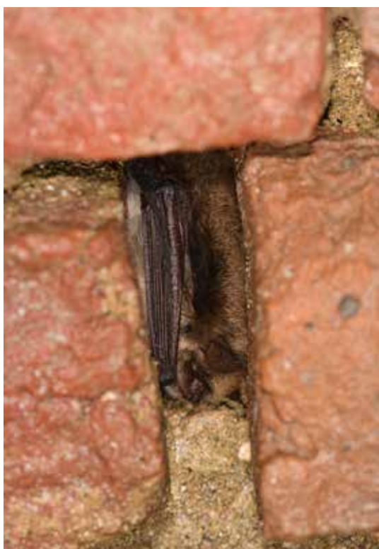
Les briques peuvent être disjointoyées pour créer des gîtes pour les espèces de chauves-souris qui apprécient les espaces étroits.
